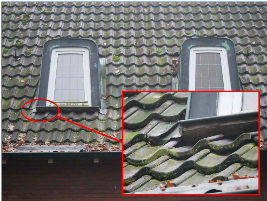
Abb. 9: Dachfenster mit fehlender Abdeckung (mögliche Einflugöffnung für Fledermäuse)
