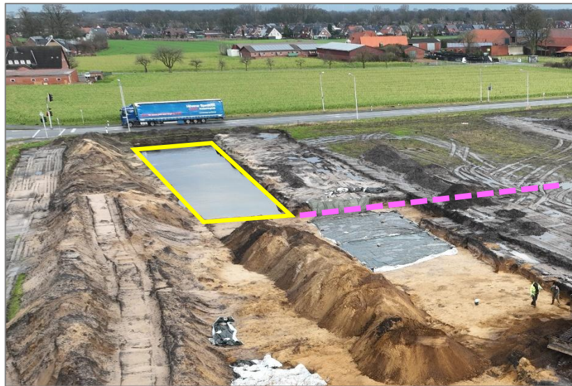
Abb. 2 Überschwemmung in bereits abgearbeitetem Schnitt (29.01.2025). Gelb zeigt die überflutete Fläche, Pink zeigt die Grenze, ab der die Schnitte vorläufig aufgezogen werden. Blickrichtung Norden
