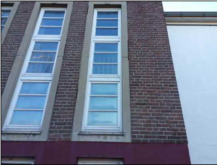
Abb. 7: Fehlstellen in der Fassade
