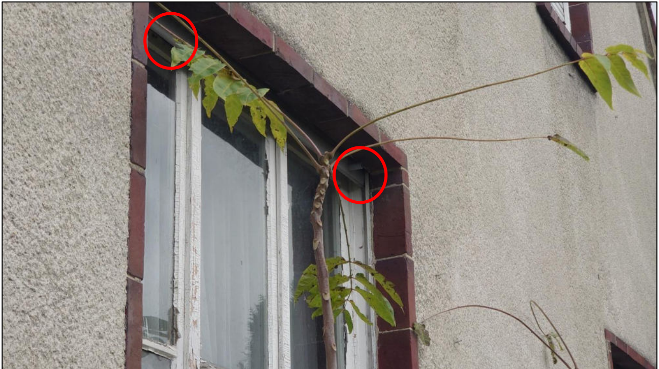
Foto 6: Fenster im Erdgeschoss mit potenziellen Quartiermöglichkeiten für Fledermäuse (rote Kreise) (30.10.2024).
