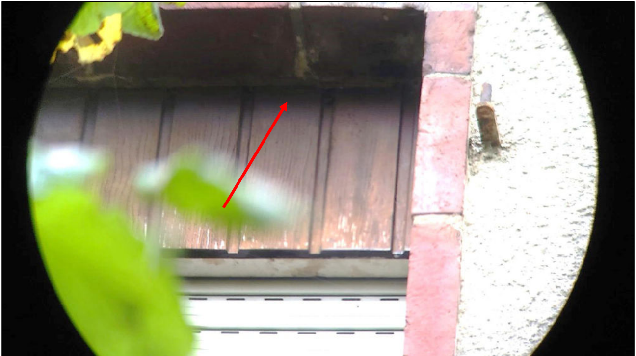
Foto 8: Quartierpotenzial für Fledermäuse hinter der Holzverkleidung (roter Pfeil) (30.10.2024).
